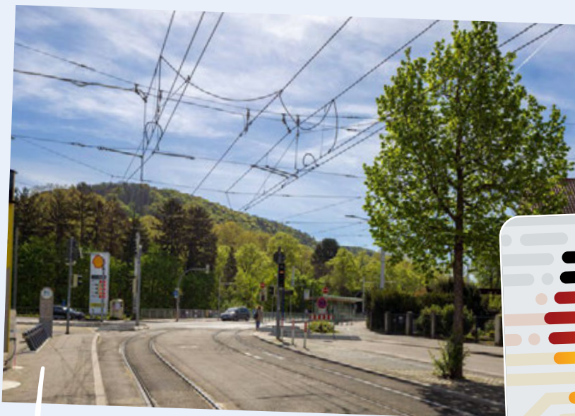
Der Gleisbogen in der Franz-Knauff-Straße, Heidelberg-Weststadt, war einer von mehreren, die im Jahr 2023 erneuert wurden.
