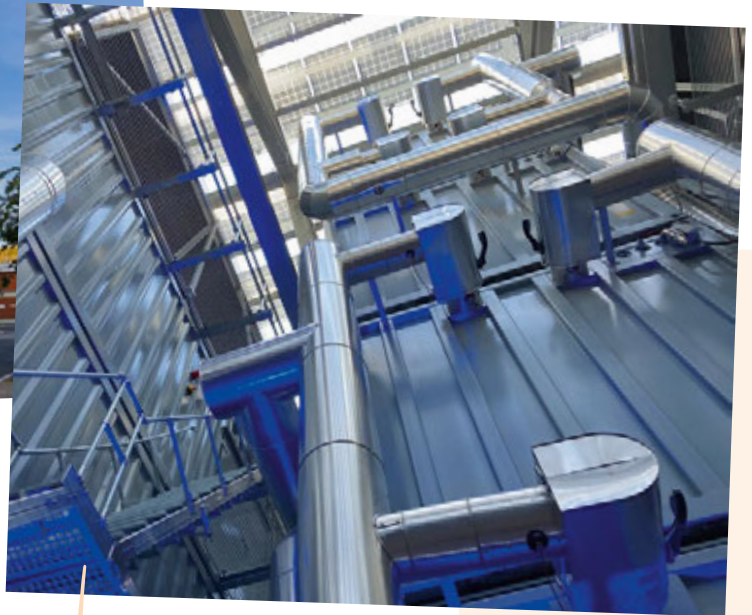
So sieht die Kältezentrale von innen aus: unten die Container mit den verschiedenen Komponenten der Anlage, oben die Solarfassade.
