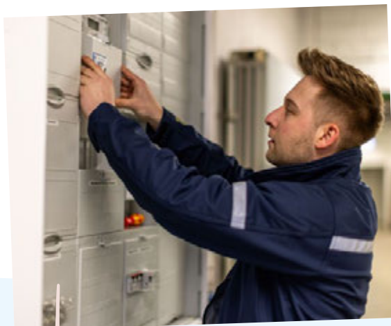
Im Jahr 2023 wurden rund 7.000 moderne Messeinrichtungen verbaut.
