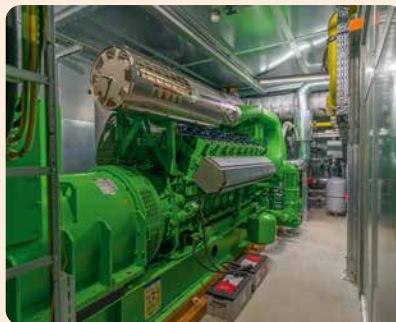
Im Heidelberg Innovation Park (hip) entstand eine Kälteanlage für eine effiziente Versorgung des Innovationsquartiers mit Kälte.
