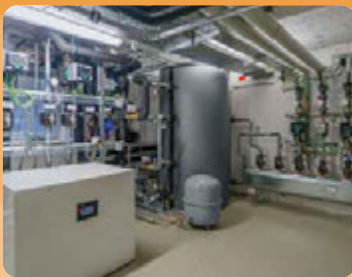
Blick ins Technikum: Wärmepumpe mit Wärmespeicher und Verteilern für ein wechselwarmes Netz.
