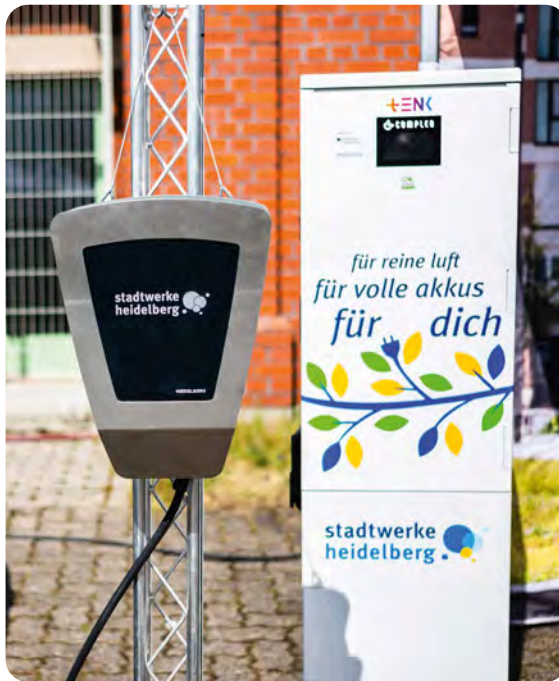
Die Stadt Heidelberg fördert Ladestationen.
