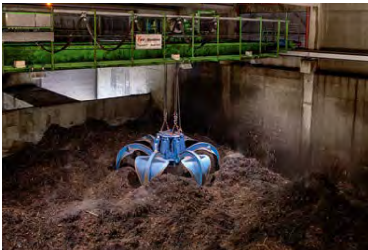
▲ 01 Im Holz-Heizkraftwerk wird zu über 90 Prozent Landschaftspflegematerial und Grünschnitt aus der Region eingesetzt.
